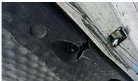
Poškodenie obloženia podlahy
