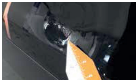
Poškodenia a trhliny
